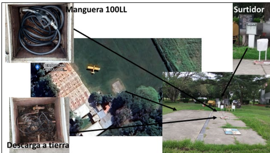
Figura 7. Instalaciones para el abastecimiento de combustible. Fuente: investigación JST
